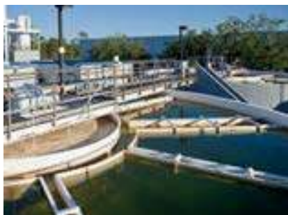
Водоподготовка и очистка
